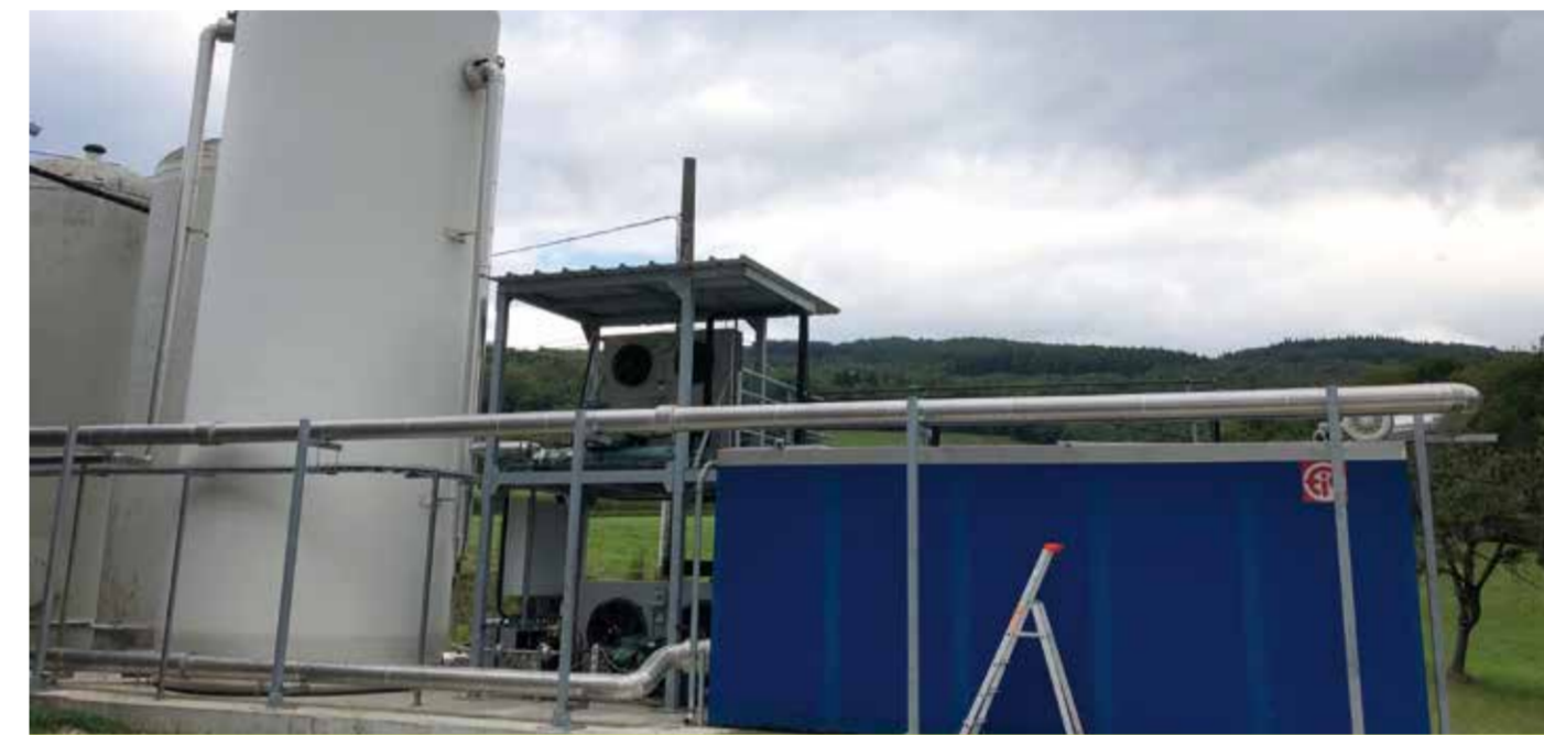
Ballon de récupération d'eau chaude, groupe froid et bac de stockage de glace
