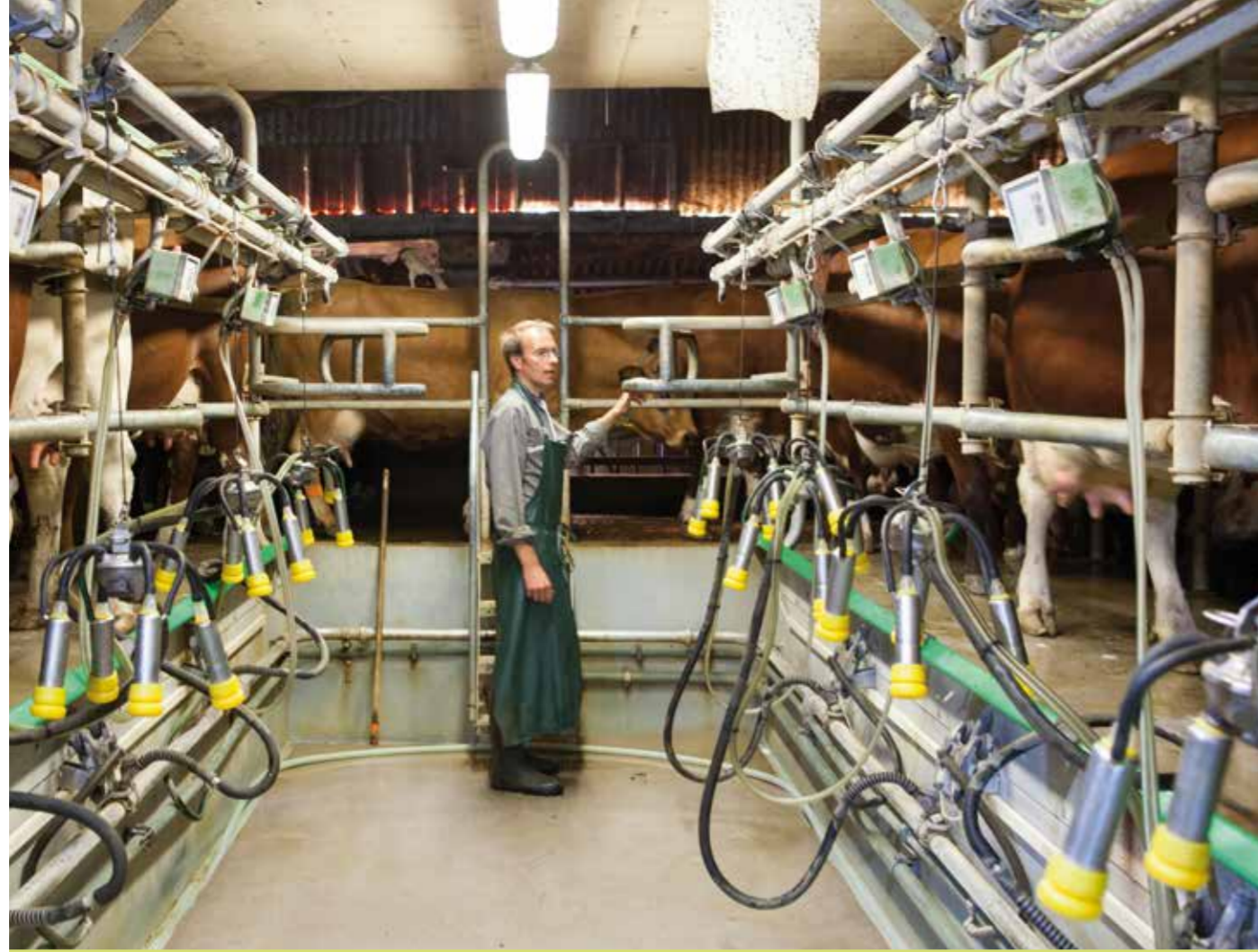
La salle de traite concentre la plus grande partie des consommations électriques d'une exploitation laitière.
