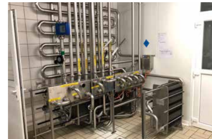
Échangeur permettant de transférer les calories au lait avant ensemencement
